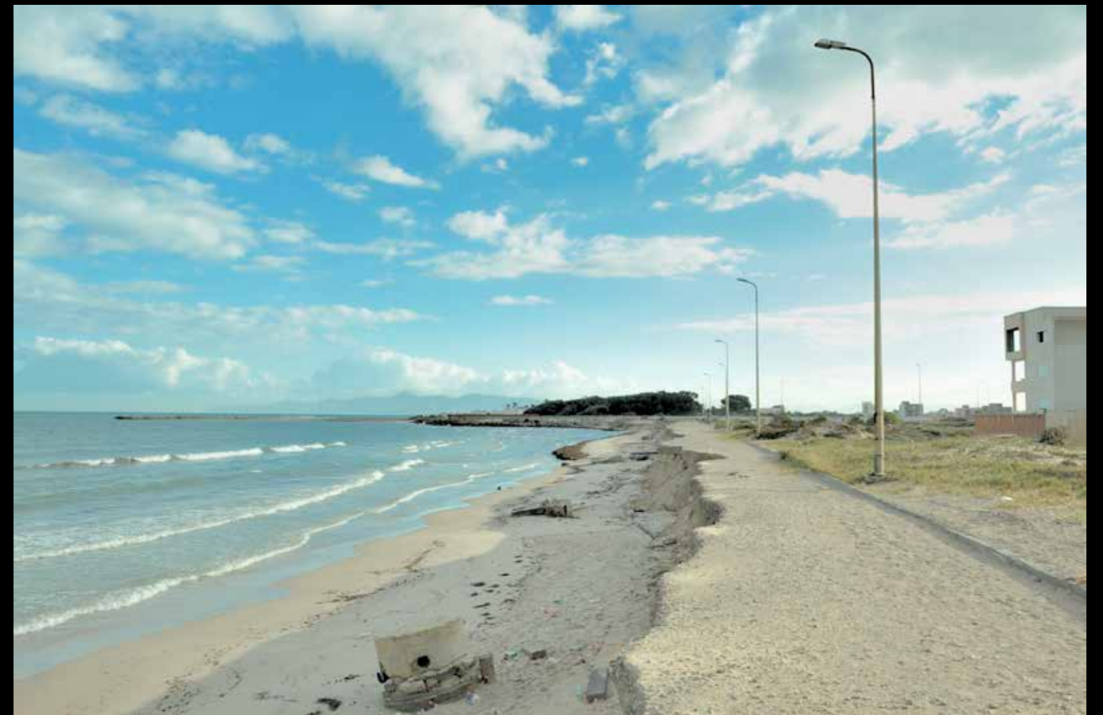
Lorsqu'on s'acharne à avoir les pieds dans l'eau (Lotissement au fond du golfe de Tunis)
