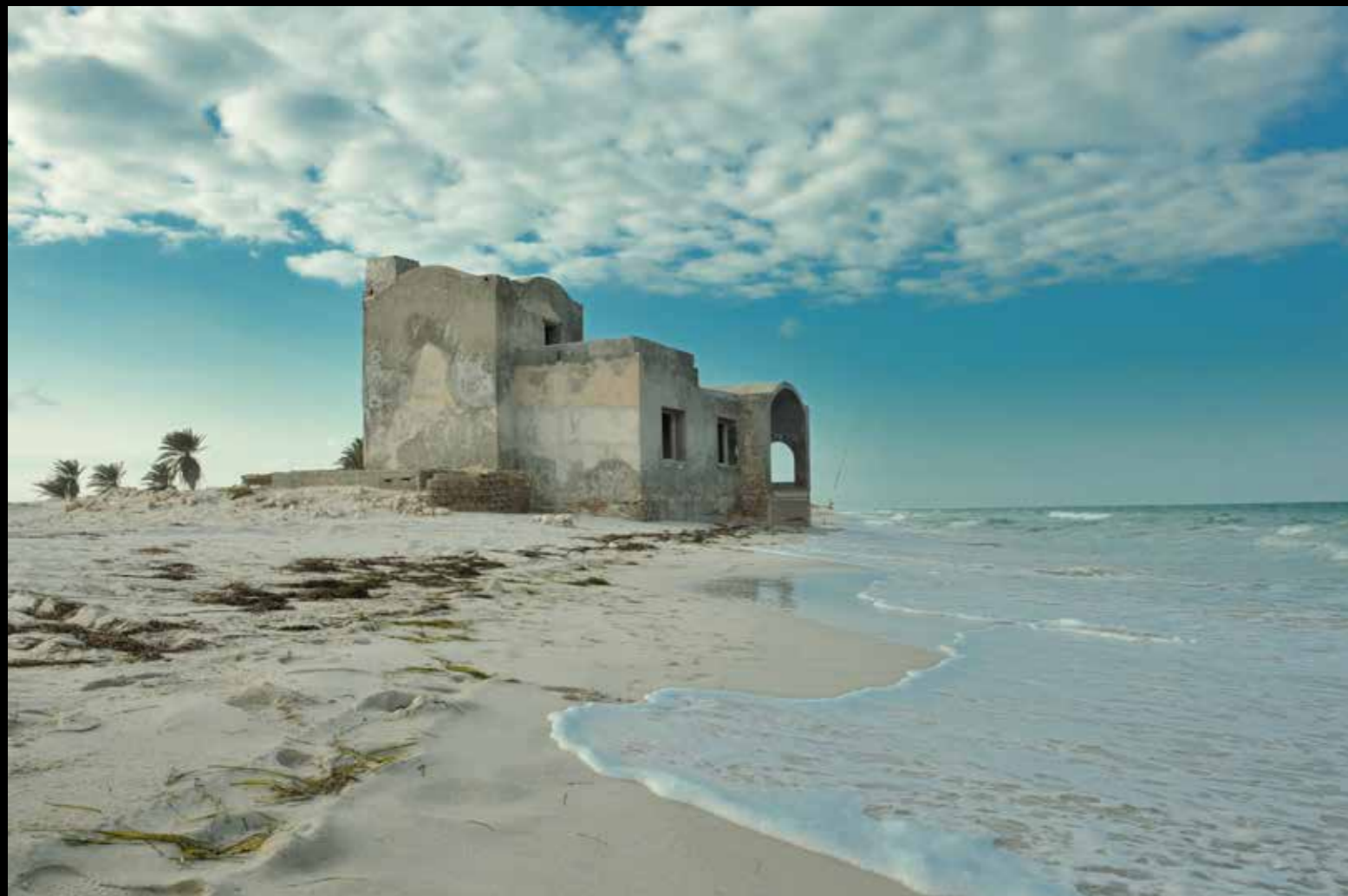
Au niveau de la racine de la flèche de Rass Errmel (Jerba) : construction presque au droit de l'emplacement d'un ancien marabout (Sidi Hacheni) déjà franchi par le rivage et annexé à la mer. Le même sort ?
